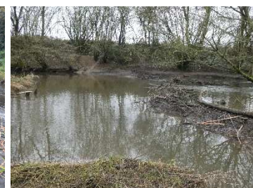
Barrage endommagé et départ de canal Février 2020
